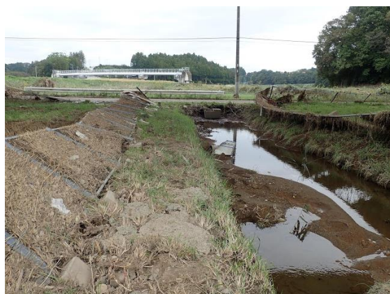
写真 2-2 田野川破堤地点付近
