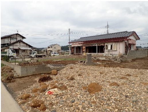
写真 3-18 住宅 B のブロック塀転倒
