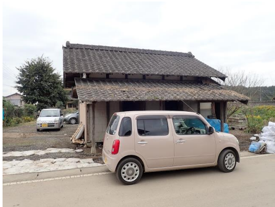
写真 2-12 家屋の屋根に残った浸水跡
