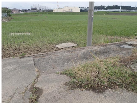
写真 2-18 アスファルトの剥がれ
