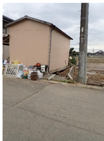
写真 3-6 基礎下の洗堀および外壁の損傷
