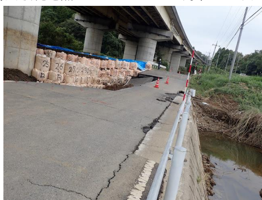
写真 2-3 田野川破堤地点付近
