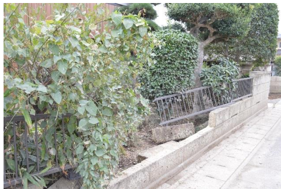
写真 3-3 ブロック塀の転倒
