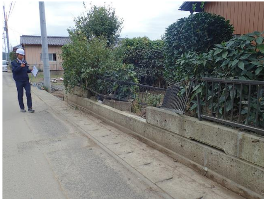
写真 2-10 東方向へ倒壊した塀
