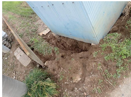
写真 3-24 物置底部の洗掘
