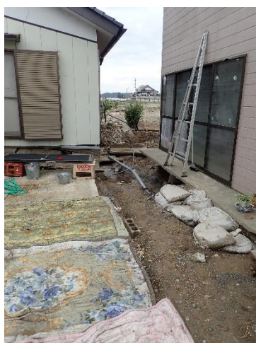
写真 3-5 住宅間の洗掘
