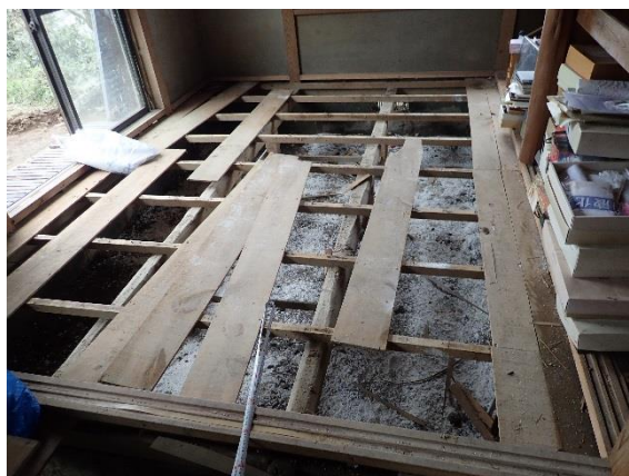
写真 3-10 床上浸水した住宅の床（消毒中）
