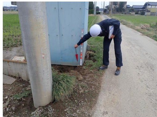
写真 2-23 洗堀痕・浸水痕
