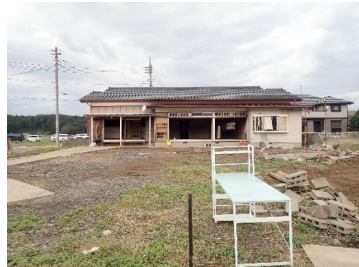
写真 3-19 住宅 B 正面の被害
