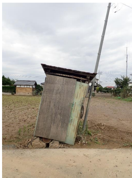
写真 3-14 傾斜した物置
