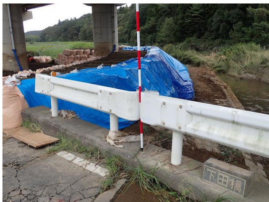
写真 2-1 田野川破堤地点
