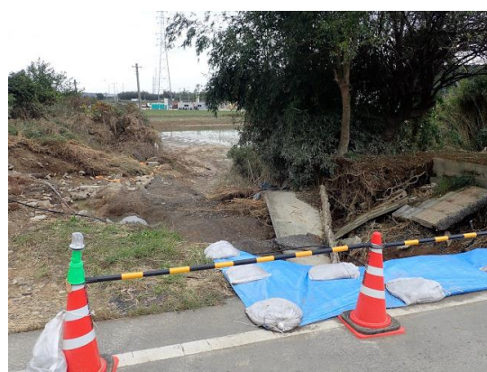
写真 2-7 侵食による塀の崩落
