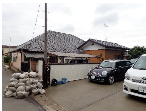
写真 3-4 カーポート屋根のめくり上げ
