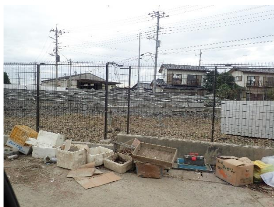
写真 3-11 ソーラーパネル被害
