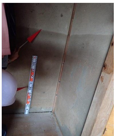
写真 3-9 床上浸水した住宅の浸水跡 (上の線が台風 19 号浸水跡, 下の線が 昭和 6 1 年の浸水跡)
