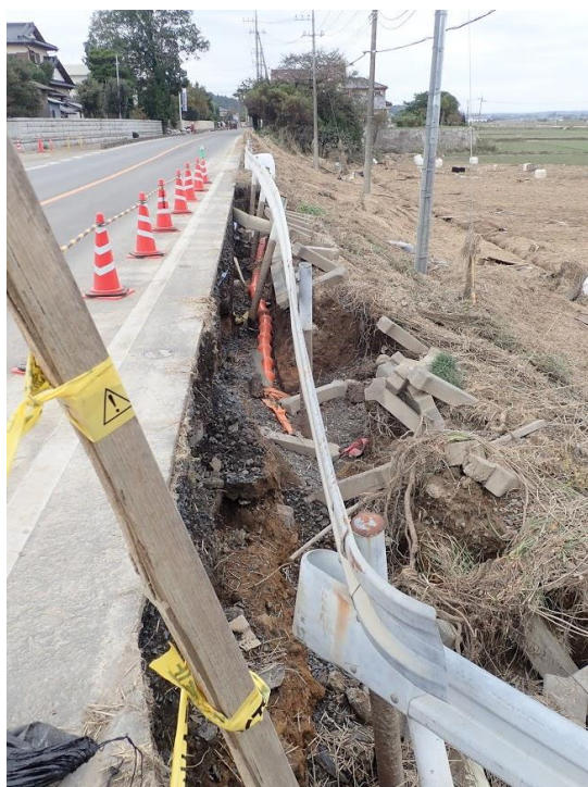
写真 2-4 ガードレールの崩落
