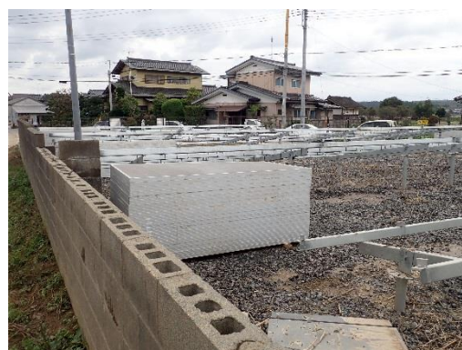
写真 3-12 積み上げられた 破損ソーラーパネル
