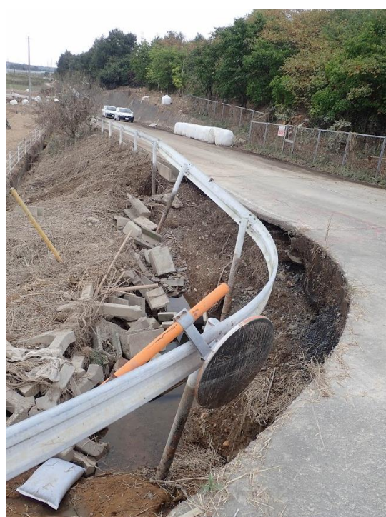
写真 2-5 カーブミラーの崩落
