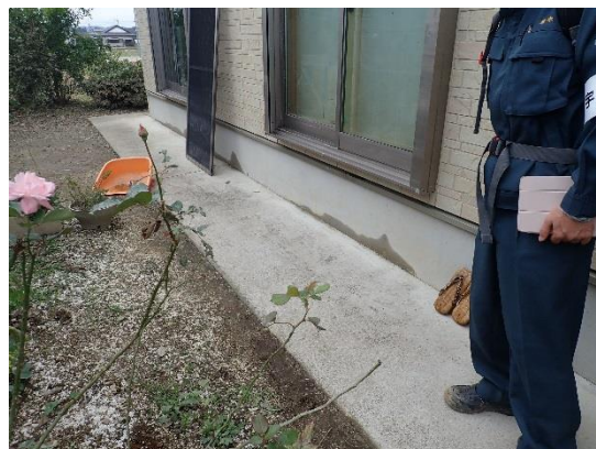
写真 3-8 基礎内にたまった水の浸透
